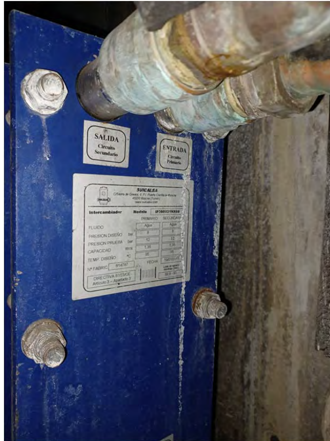
Circuito primario del sistema de captación solar A.C.S. SUICALSA IP360031NX08
