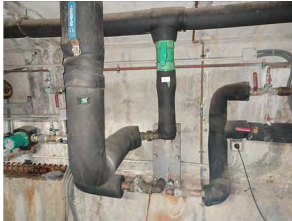
Circuito primario del sistema de captación solar piscinas. SUICALSA IP360021NX08PTI
