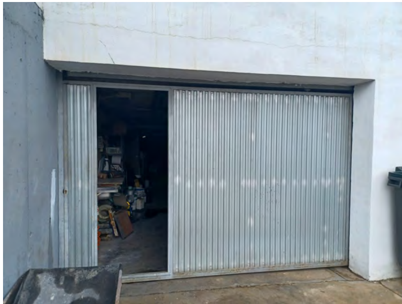
Entrada sala de instalaciones
