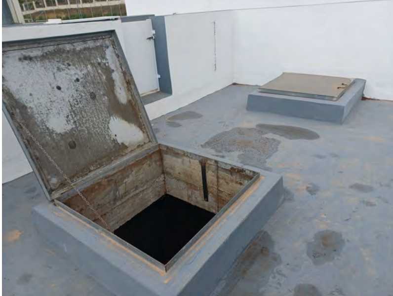
Boca de hombre silo
