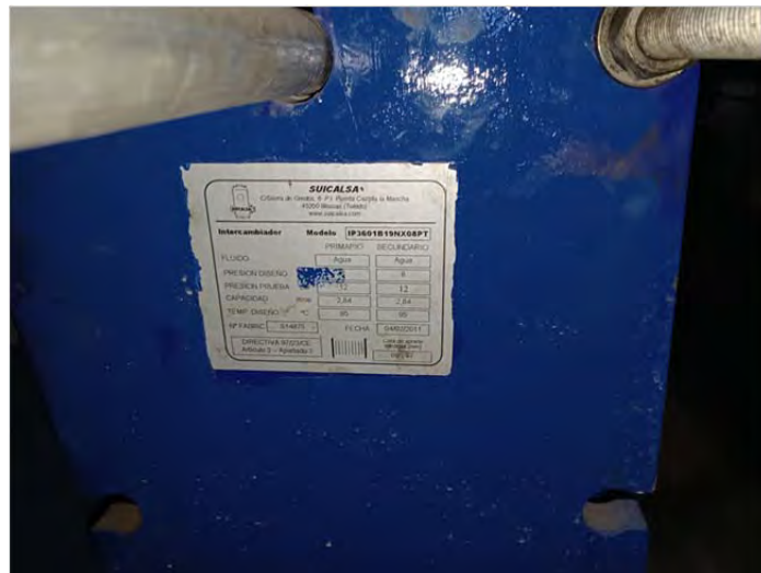
Circuito piscinas. Dos intercambiadores. SUICALSA IP3601B19NX08PT
