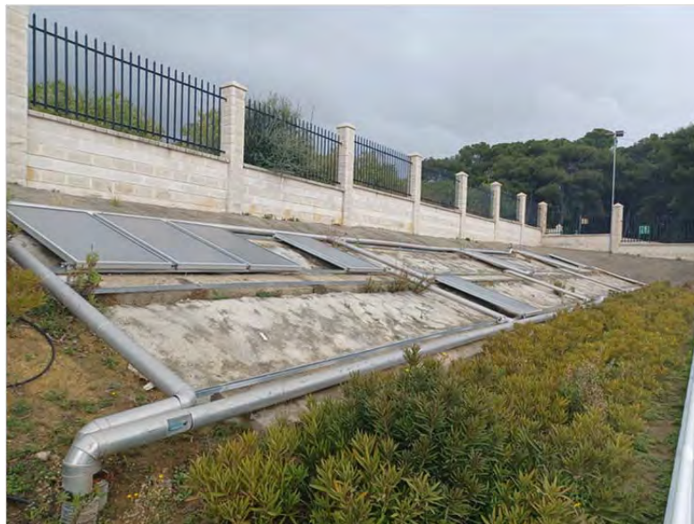
Sistema de captadores A.C.S
