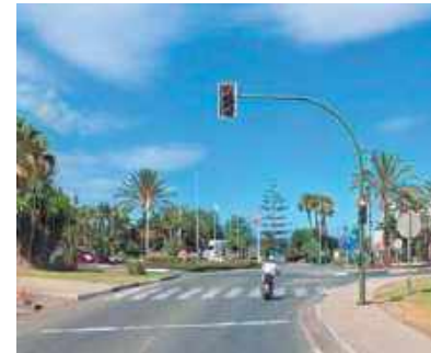
Ilustración 9. Control semafórico del ramal de la Salida 184 Marbella / Centro Urbano / Polígono Industrial
